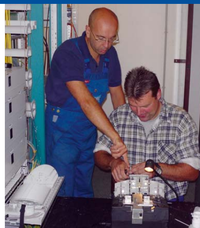
Ausbildung: Ein Mitarbeiter der Stadtwerke Karlsruhe zeigt, worauf es beim Arbeiten mit dem Fusionspleißgerät ankommt.
